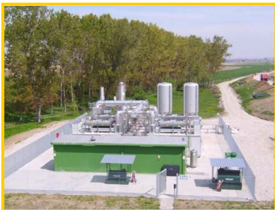
Foto 5- Impianto di recupero energetico da biogas
